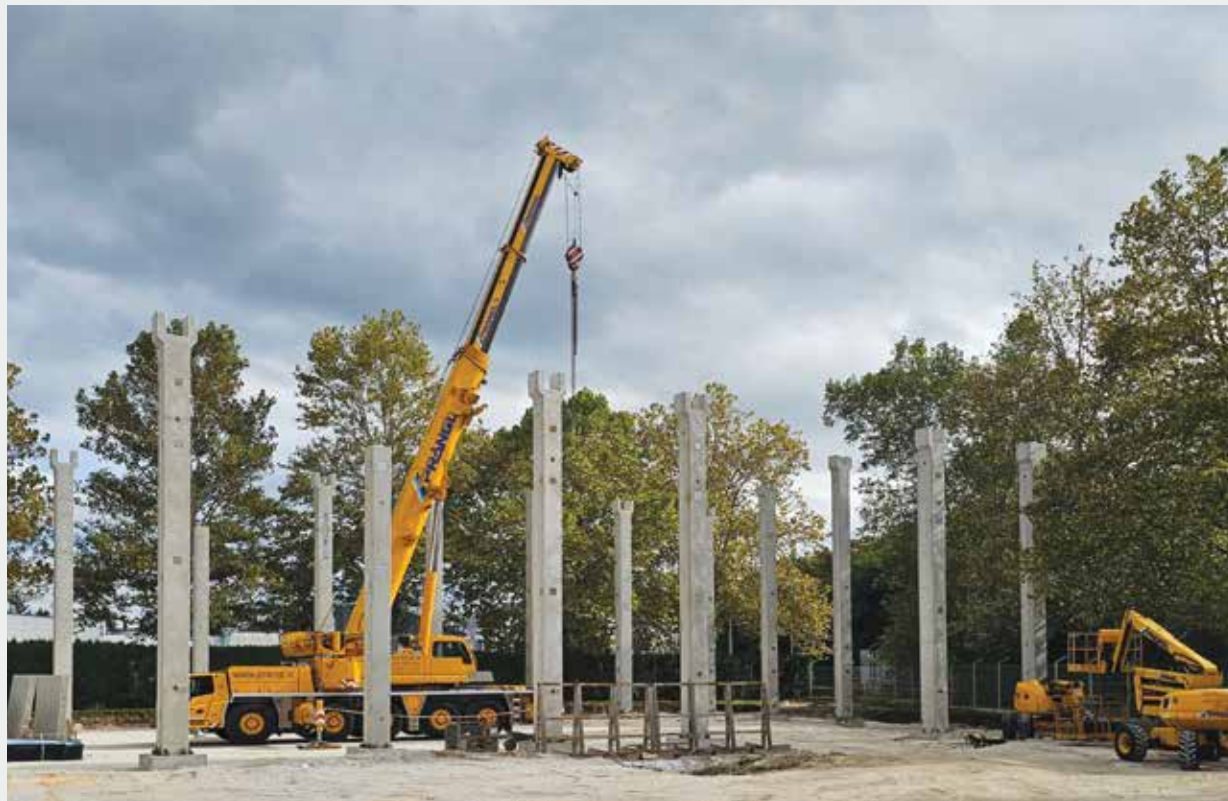
Kotel na lesno biomaso v gradnji Foto: Energetika Maribor
